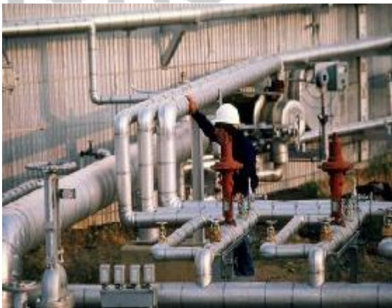
Obr. 6.1 Vonkajšie uloženie potrubí
